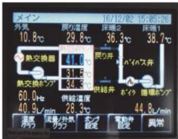
灯油ボイラー単独運転時
