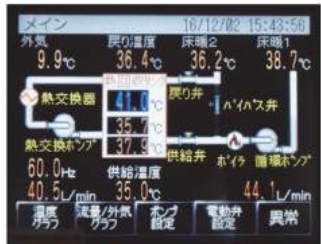
発酵熱・灯油ボイラー併用運転時
