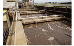
尿の浄化施設
