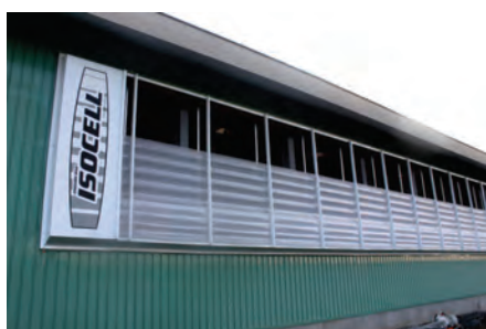
自動換気システム
